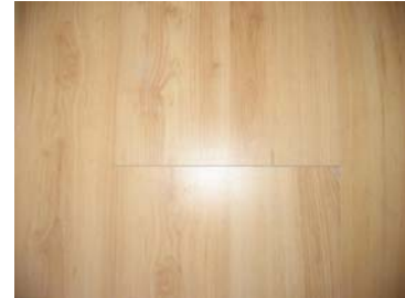
18. kép A laminált padlóburkolat elemek illesztése nem megfelelő.
