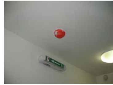
61. kép A lépcsőházban a szerelvények takarítása elmaradt.
