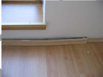
16. kép A padlóburkolat szegélye elválk a faltól
