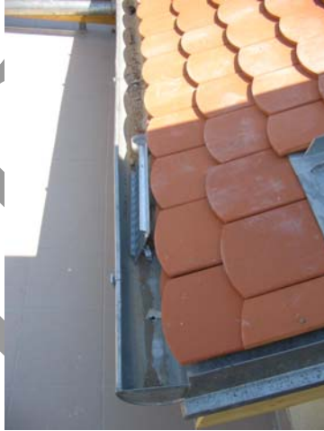
42. kép A tetőfedés esztétikailag is kifogásolható.
