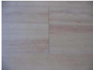
20. kép A laminált padlóburkolat elemek illesztése nem megfelelő..
