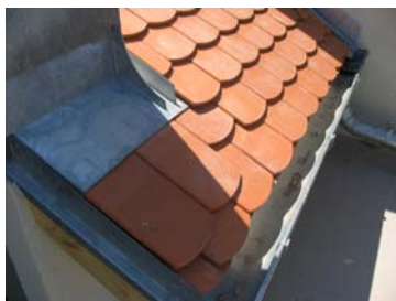
48. kép A cserepek elhelyezése esztétikailag nem megfelelő.
