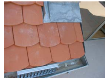
47. kép A cserepek elhelyezése esztétikailag nem megfelelő.
