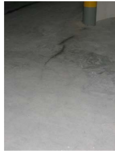
79. kép Repedés a padló beton felületén
