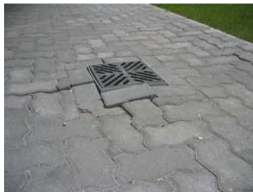
63. kép A földszinti parkolóhelyeknél a vízvezetés nem megoldott. Az összefolyó körül a burkolat sérült.
