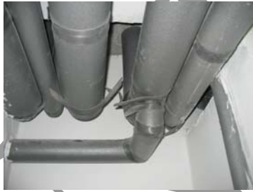
59. kép. A gépészeti csövek hőszigetelése már több helyen elvált.
