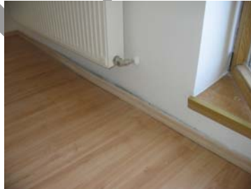
17. kép A padlóburkolat szegélye elválk a faltól.
