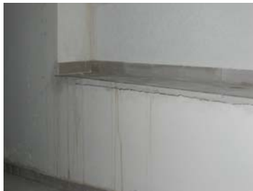
74. kép Ázásnyom a padló közelében.
