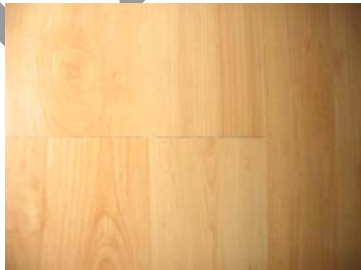
19. kép A laminált padlóburkolat elemek illesztése nem megfelelő.
